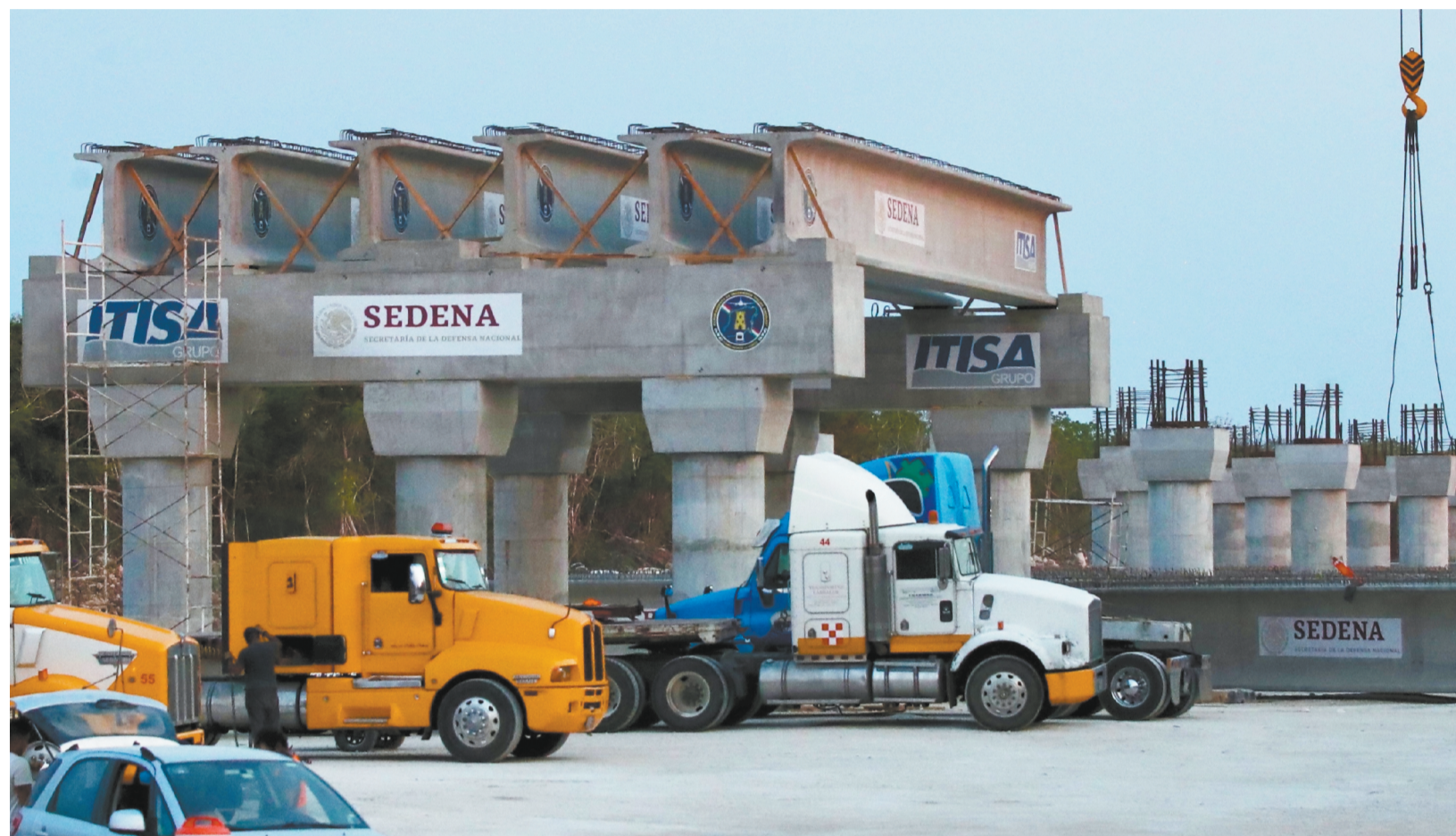
En diversas partes de las estructuras de concreto es visible el logotipo de la Secretaría de la Defensa Nacional.
